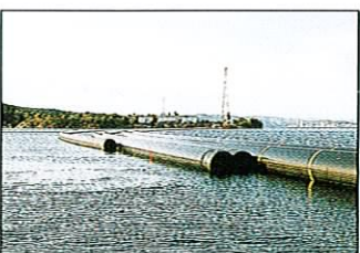
Intags- och utloppsledning för en avsaltningsanläggning, Larnaca Cypern, 1999, storlek: 1200 och 1000mm. Längd: 2550 m.
