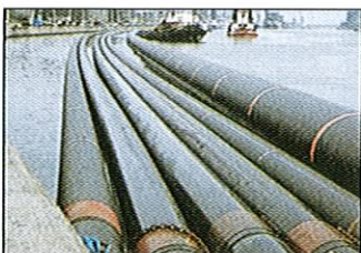
Vattenledningsnät och vattenintag, Szczecin, Polen, 1993, storlek 1600 mm och 800 mm, längd 5900 m.
