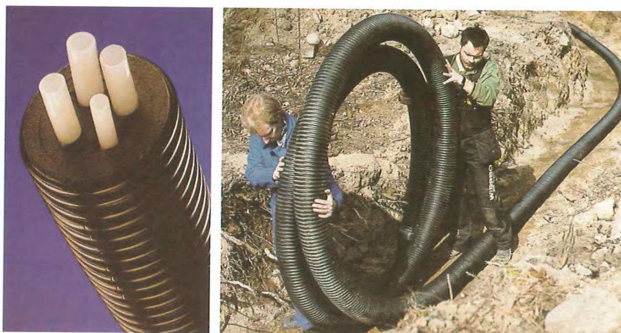
Fig. 22: Exempel på isoleringsrör och förläggning
